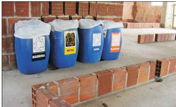
Figura 10: Exemplo de equipamentos simples de acondicionamento segregado de resíduos classe B, dispostos nos pontos de geração.
